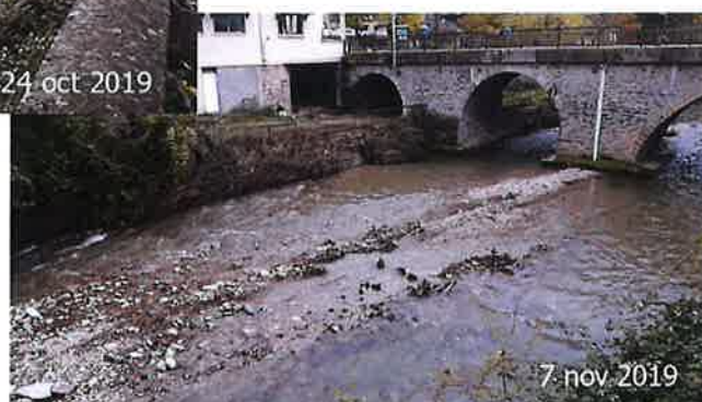
Banc de graviers en aval du pont – après la Q 10 du 21 octobre 2019
